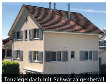
Tonziegeldach mit Schwarzalgenbefall
